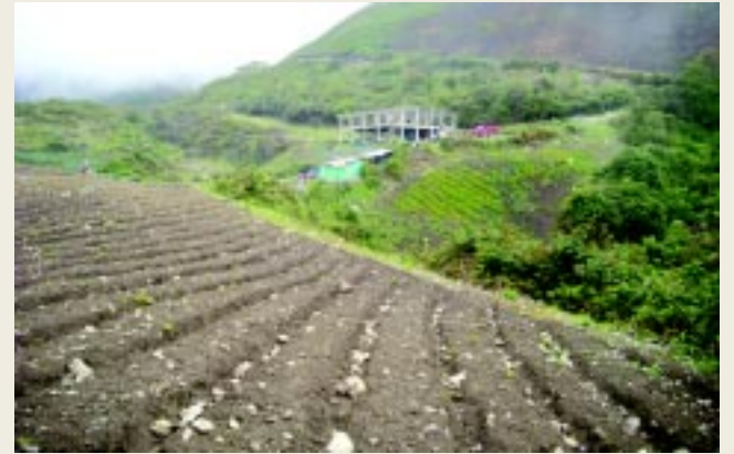
Panorámica del terreno en construcción del Centro de Rehabilitación “Llamados Triunfar” en el sector la Pepita.
